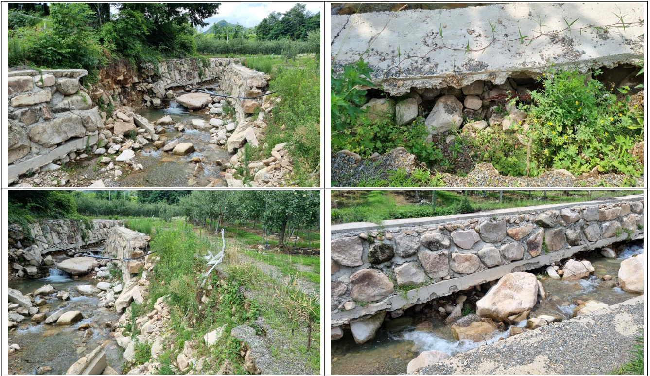
[그림 1] --천 부적정 시공 현황
