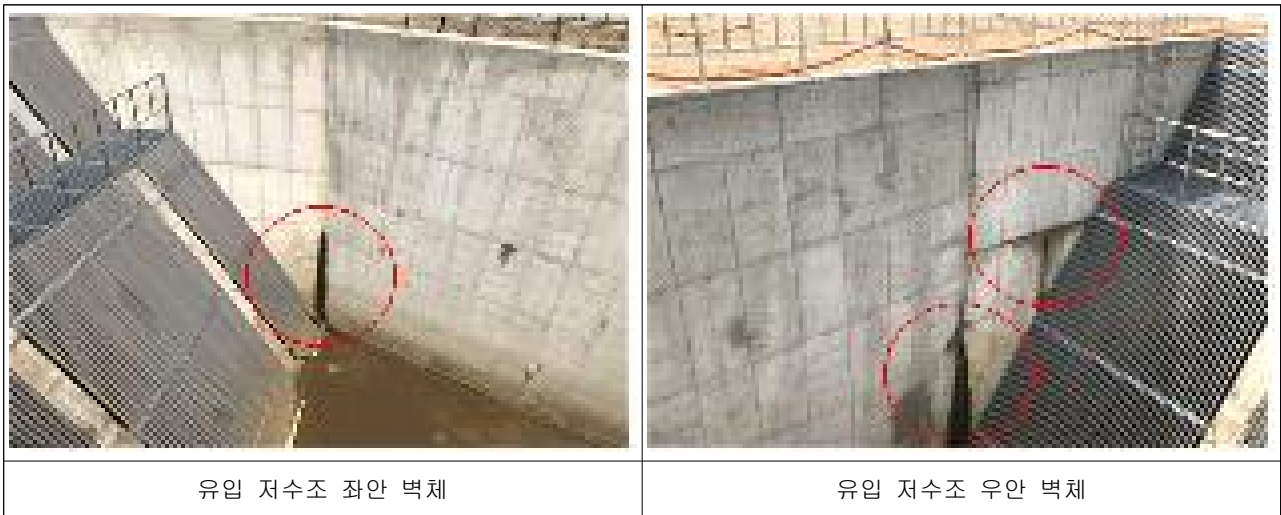
[그림] 유입 저수조 균열에 따른 누수 현황
